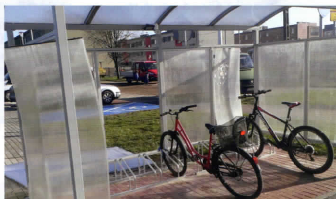
Uszkodzone wiaty rowerowe w Lisowie
