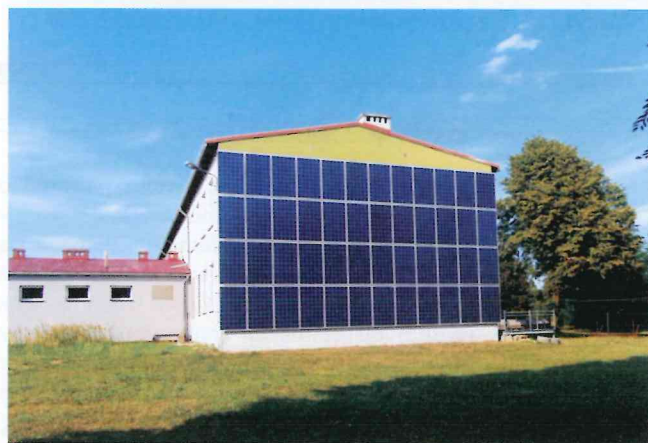
Instalacja fotowoltaiczna 12 kW na budynku szkoły w Hadrze
