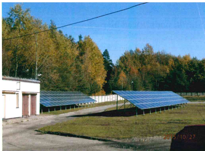
Ogniwa fotowoltaiczne na oczyszczalni ścieków w Herbach
